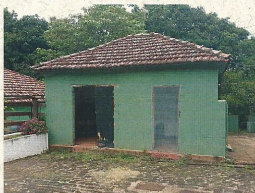
Foto 02: Parte da estrutura da sede, sem portas. Prejudicando o armazenamento dos materiais.
