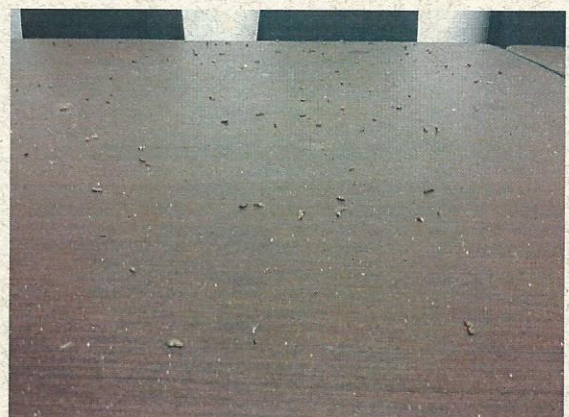
Foto 06: Fezes de rato, deterioração do patrimônio público.
