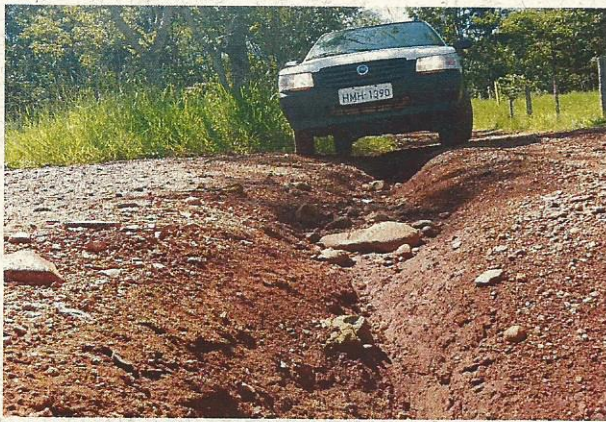
Foto 11: Estrada de acesso ao Parque em constante necessidade de manutenção.
