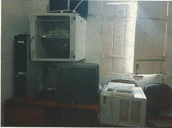
Foto 09: Condições precárias da rede elétrica e da rede de internet
